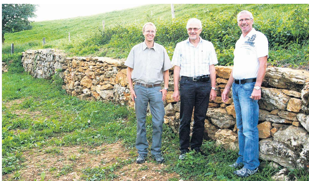
Freuen sich über die restaurierte Bruchsteinmauer: Creanaira-Geschäftsleiter Ulysses Witzig mit den Gemeinderäten Markus Kreis und Urs Vollenweider (von links).
